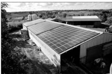
Installation de 96 kWc à Saint-Hilaire de Voust (85). Des espaces ont été aménagés entre les panneaux pour laisser passer la lumière naturelle.
