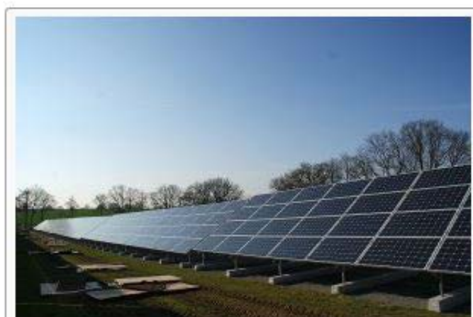
Centrale photovoltaïque de 3,36 MWc de Cazaubon. Photo : Sergies
